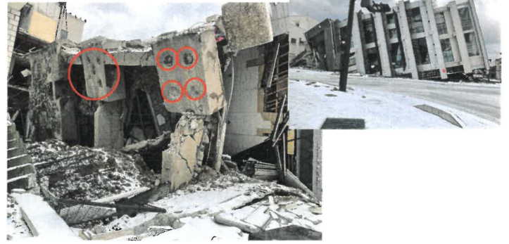
※杭が折れている
